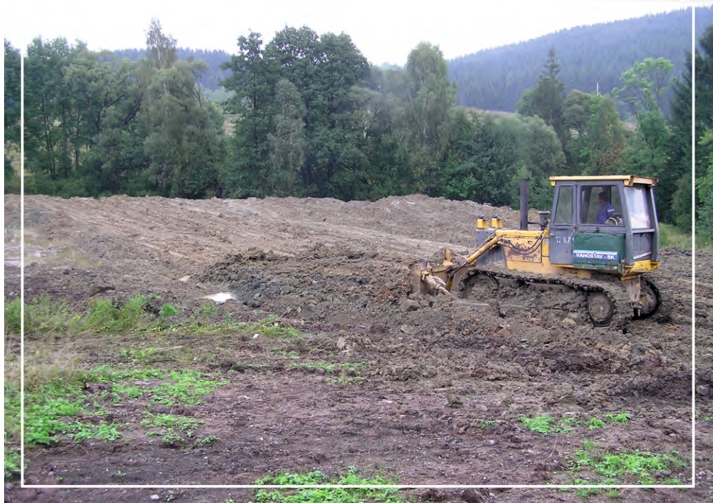
Ničenie podmäčianých lúk zavezením výkopovou zeminou v alúviu Milošovského potoka pri Čadci.
